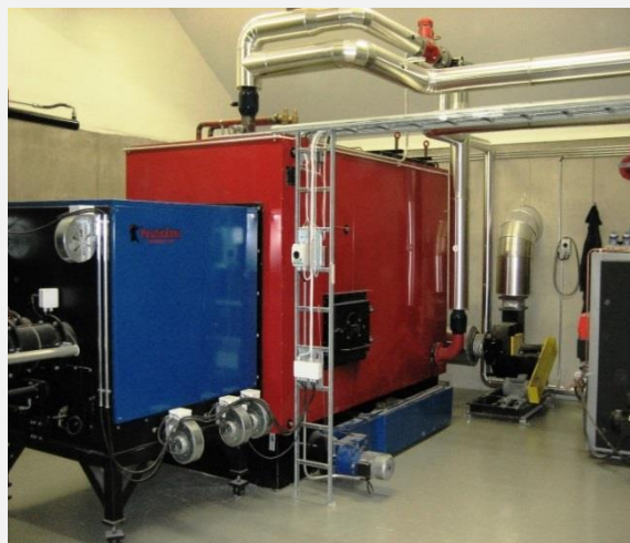
Котел Laka PS 500 кВт с горелкой для щепы компании Biofire
